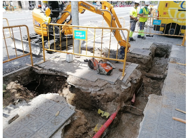
10. Ramals de descàrrega a tocar del c. d'Ocata.
